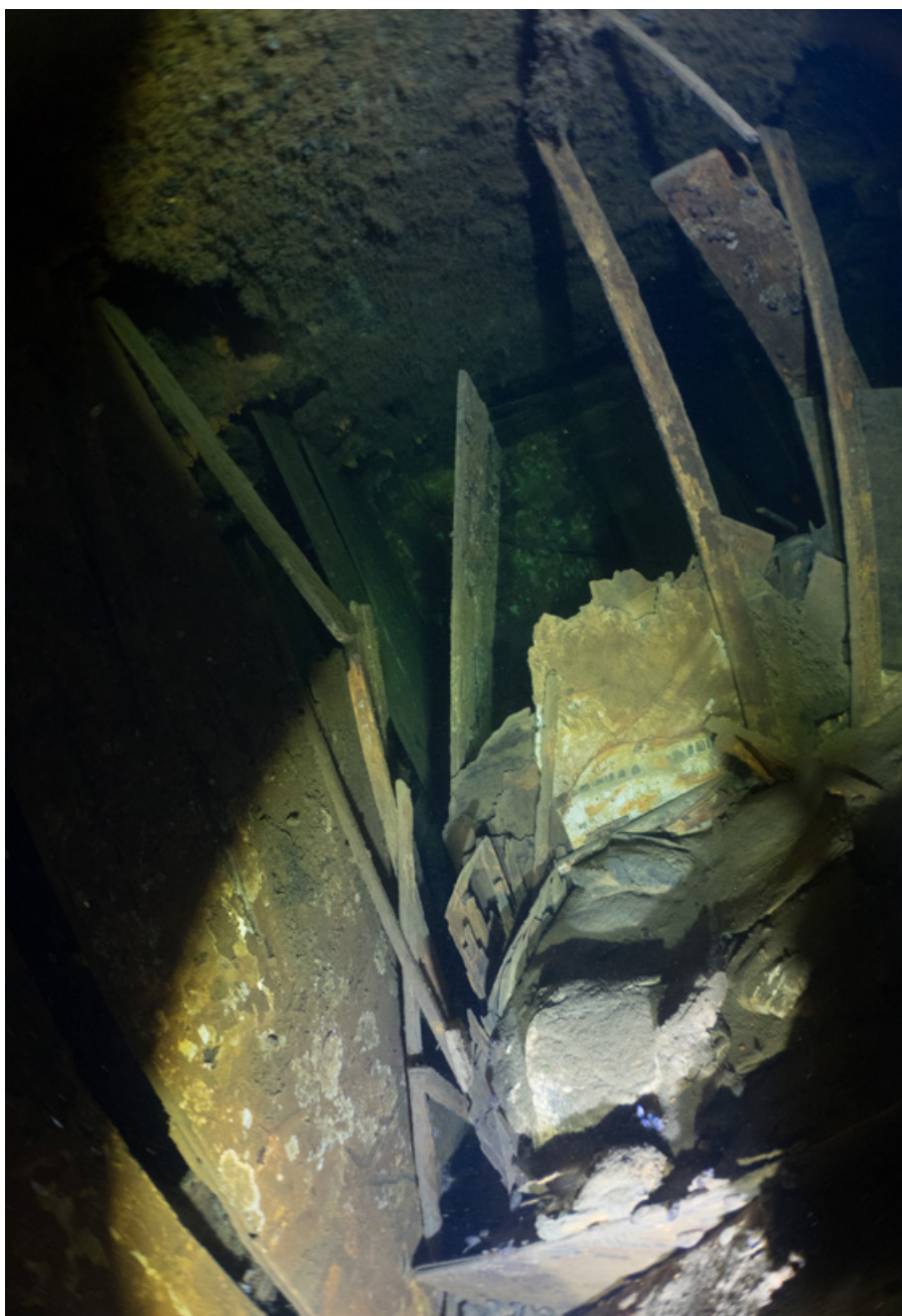
Zdjęcie 9. Zerwane wyposażenie i śmieci tarasujące wejście do pomieszczeń przepompowni (źródło: ekspedycja 2018, fot. M. Czermiński)
