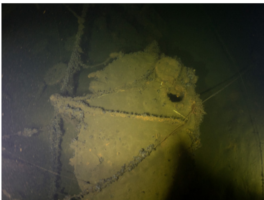
Zdjęcie 20. Pokrywa zbiornika paliwa na lewej burcie przy dziobowej nadbudówce – widoczny otwarty właz rewizyjny. Jeżeli w zbiorniku było paliwo lekkie – zbiornik jest już pusty, jeżeli paliwo ciężkie – konieczna jest inspekcja wewnątrz zbiornika w celu potwierdzenia lub wykluczenia obecności paliwa (źródło: ekspedycja 2018, fot. M. Czermiński)
